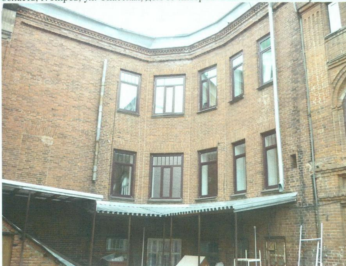
Фото 3. Вид со двора на объект культурного наследия. Автор съёмки – Брызгалов Ю.П., дата съёмки – 15 сентября 2015 г. Кировская область, г. Киров, ул. Спасская, дом 15 литер А «Магазин П.П. Клобукова».
